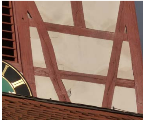
Oben: Neue Schäden am Fachwerkturm unserer Kirche. Unten links: Ein neues Geländer im Turmeingang.
